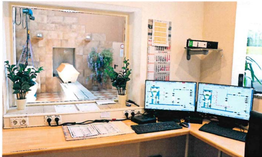
Die Schaltzentrale des Krematoriums: Von hier aus wird der Ofen gesteuert – fast alles wird per Knopfdruck gesteuert und kontrolliert. FOTOS (3): MARCUS J. PFEIFFER
